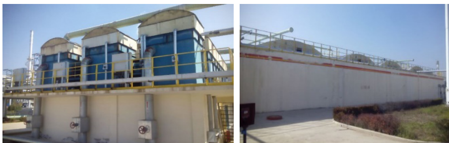
图 1-10 废水处理池现场图
